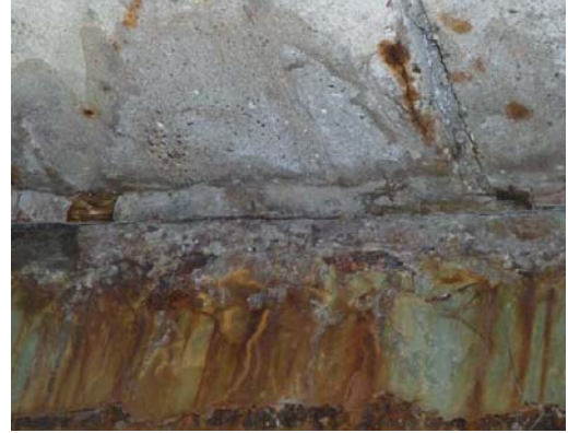
Mörtel unter den Gehwegfertigteilen
