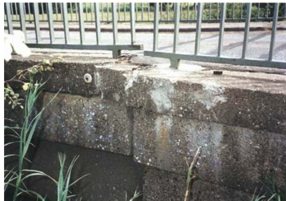
Kragarm aufgrund von Zwängungen verschoben
