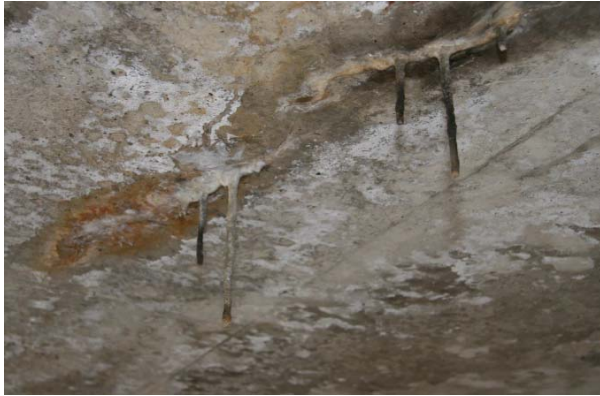
Stalaktitenbildung infolge Durchfeuchtungen
