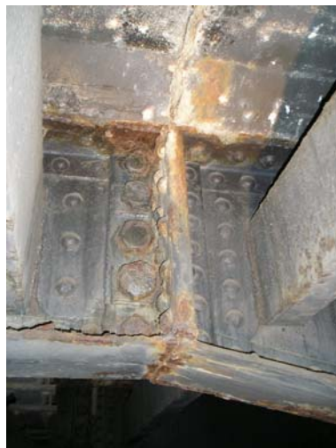
Korrosionsschäden am Tragwerk
