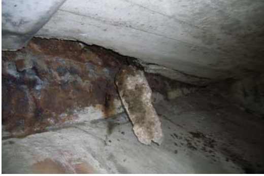
Kragarm – Kante abgeplatzt
