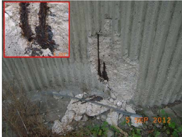
Sandbergbrücke - Abplatzungen mit freiliegender Bewehrung
