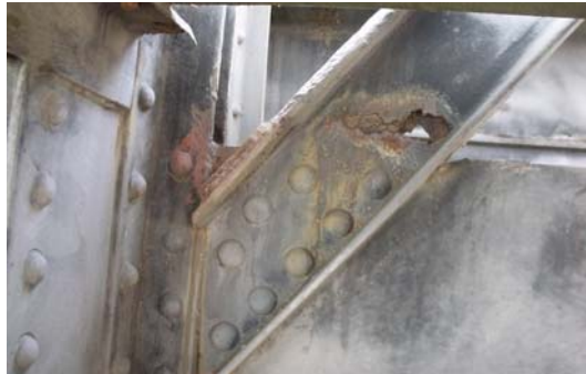
Starke Schädigung eines Knotenpunktes
