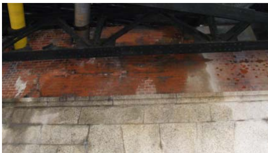
Durchfeuchtungen Widerlager Vorstadtseite
