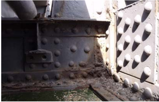
Fortgeschrittener Schaden am Untergurt
