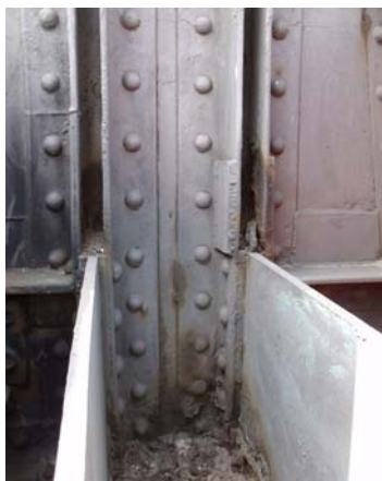
Hafendrehbrücke – fehlerhafter konstruktiver Korrosionsschutz
