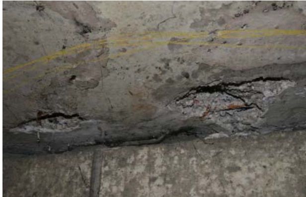
Kiesnest mit freiliegender Bewehrung
