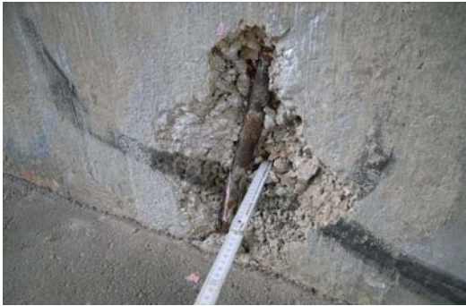
Widerlager – freiliegende Bewehrung
