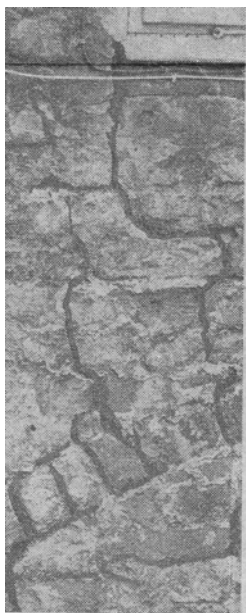
„Eine verwittert und rissige Backsteinfassade“.
