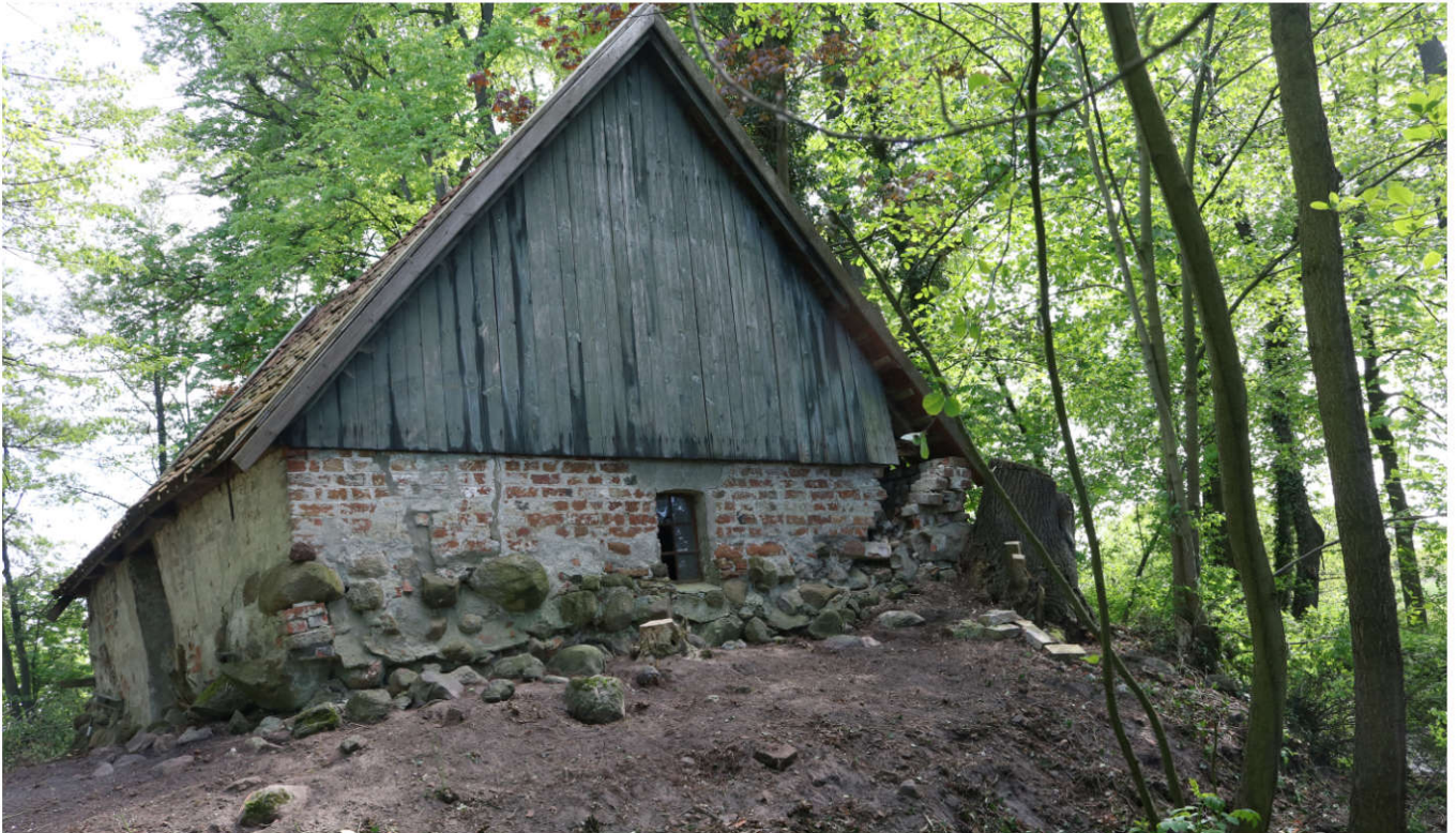
Abb. 14 Das kleine Backsteingebäude im Randbereich der Gutsanlage war in den letzten Jahren vor der Sanierung durch Witterungseinflüsse und sich ausbreitenden Bewuchs sehr in Mitleidenschaft gezogen. Das Foto zeigt den Zustand im Mai 2019 vor Beginn der Sanierungsarbeiten.
