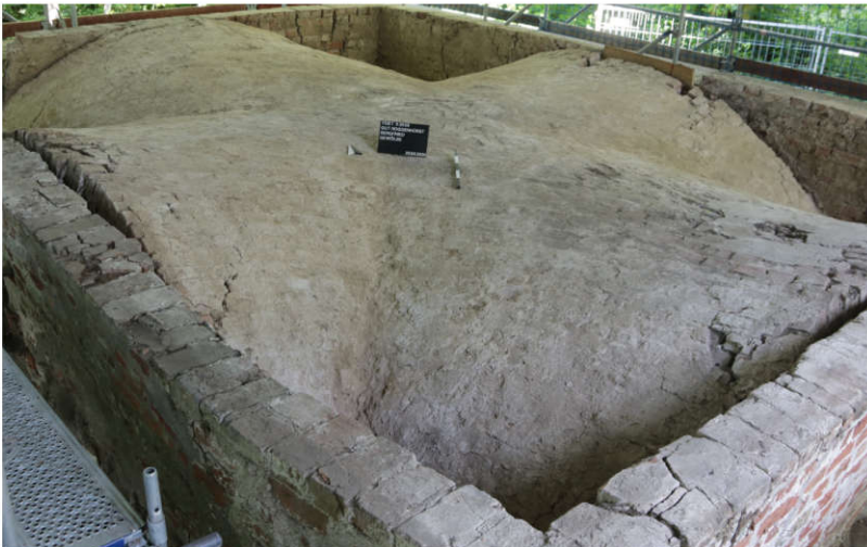
Abb. 17 Zwischen Mauerwerk und Gewölbe klaffen zum Teil erhebliche Lücken.
