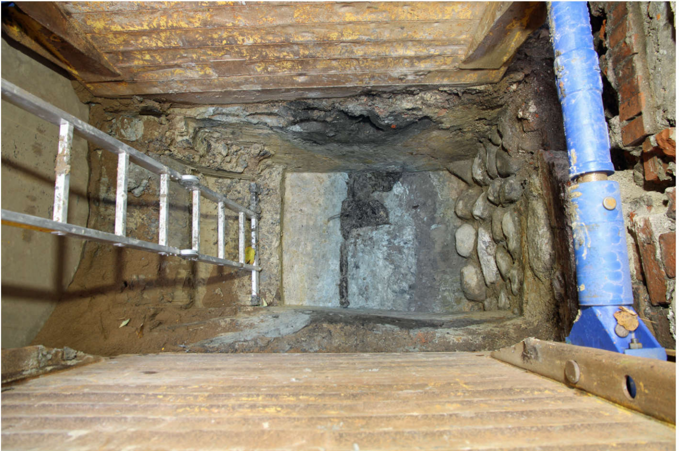
Abb. 15 Massive Baugrubenaussteifung für das Steinwerk aus Bohlen und Pfosten, dendrodatiert 1174. Rechts daneben oberer Teil des Findlingsfundamentes.
