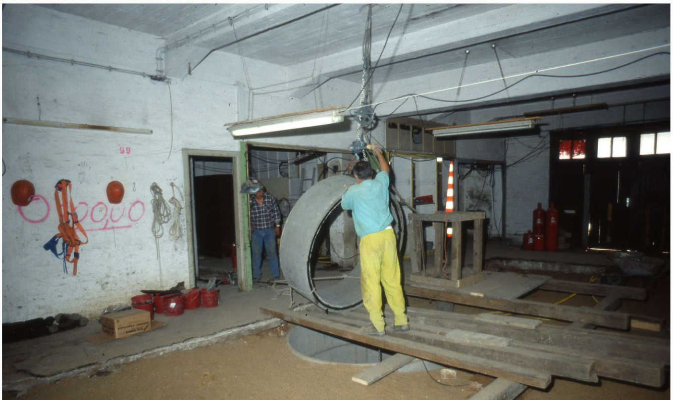
Abb. 3 Abtiefung von Brunnenring 2 mithilfe von Betonringen. Damit konnte bis in eine Tiefe von 8 m vorgedrungen werden.
