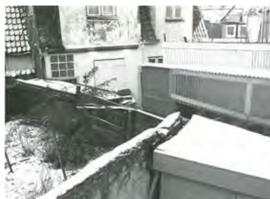
09.1 Sanierungsbedarf im Innenbereich von Block 4
