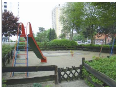
Sanierungsbedarf – Spielplatz Mühlenweg
